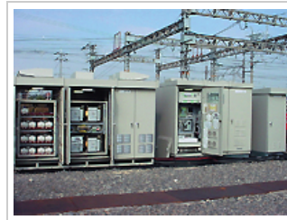
電力補完装置
